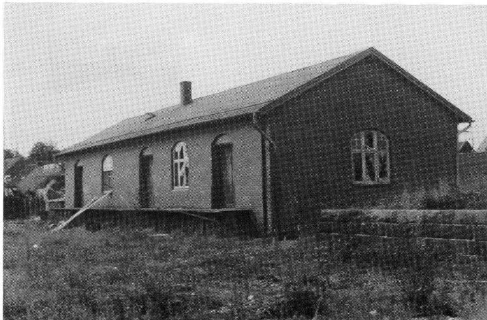
OKMJ's store varehus i Kerteminde under nedrivning i 1972. Bemærk i forgrunden th. den gamle, brede rampe med granitopmuret front mod sporet, der 5-6 år tidligere lå her langs hus og rampe, idet billedet er taget mod SSV. Foto: Sejer-sen.
